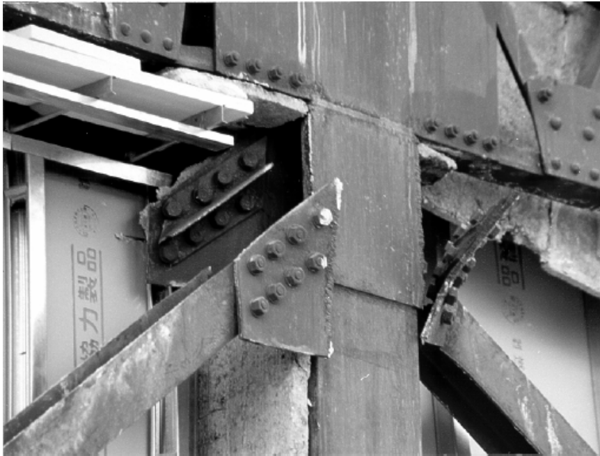
شکل (۵-۱) گسیختگی اتصالات جوشی بادبندها
