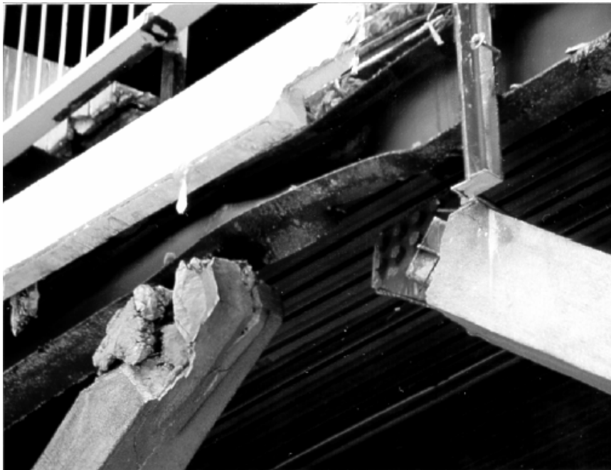
شکل (۴-۱) اعوجاج شدید تیر، بدون تکیه گاه جانبی در محل اتصال به بادبندهای شورن
